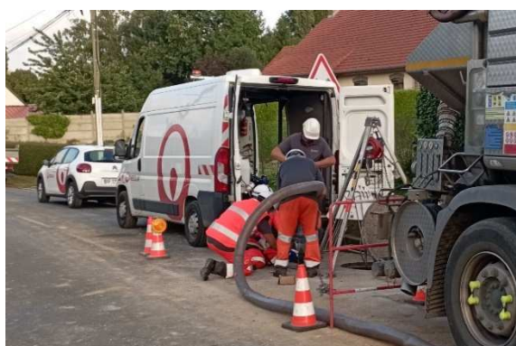
Exploitation des postes de relèvement
